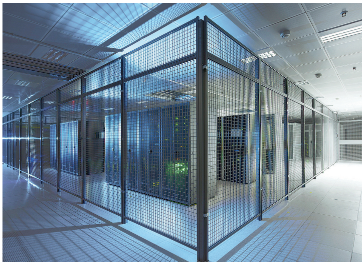
Il data center di Deutsche Telekom, in Germania/Foto Imagoeconomica
